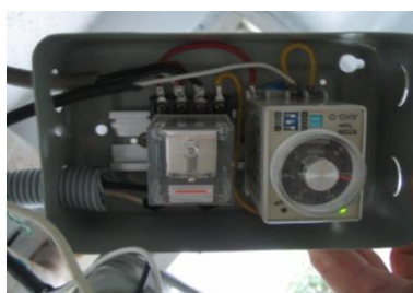
圖 5 送風機重置開關裝置
