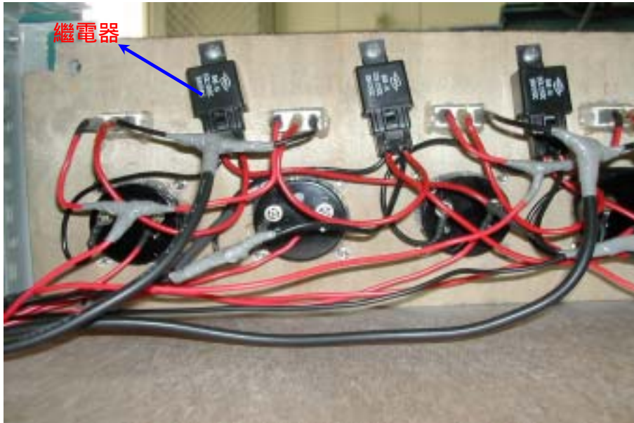
圖 6-8 電壓電流錶配線
