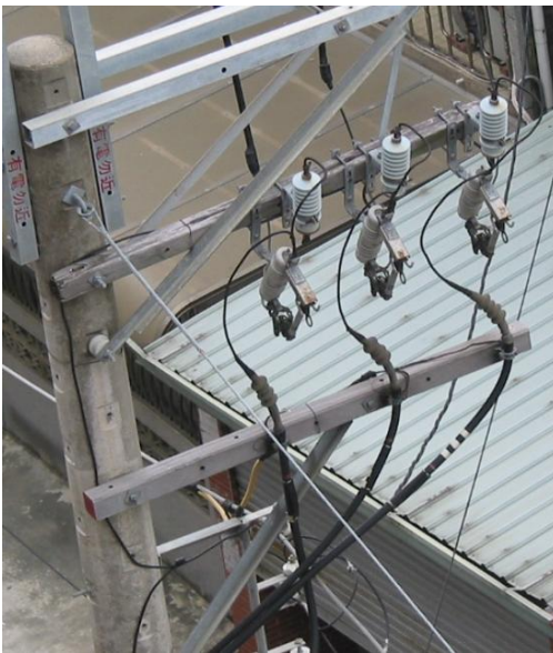
圖 3(a)：實際避雷器裝設引線照片
